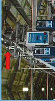
【搾乳ユニット搬送レール】
